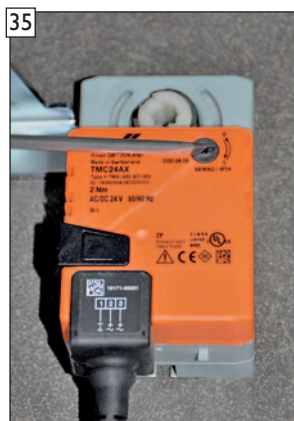
Drehrichtungsschalter auf „0“ stellen.
